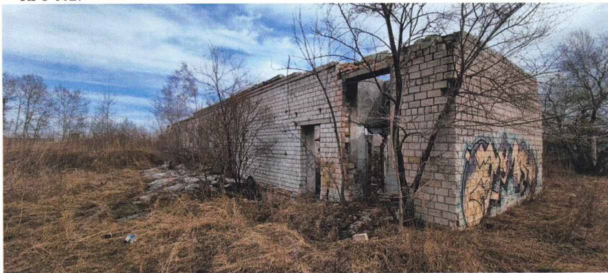
Фотография 1 (28:05:010602:91 - разрушенное здание в границах КРТ 602)
